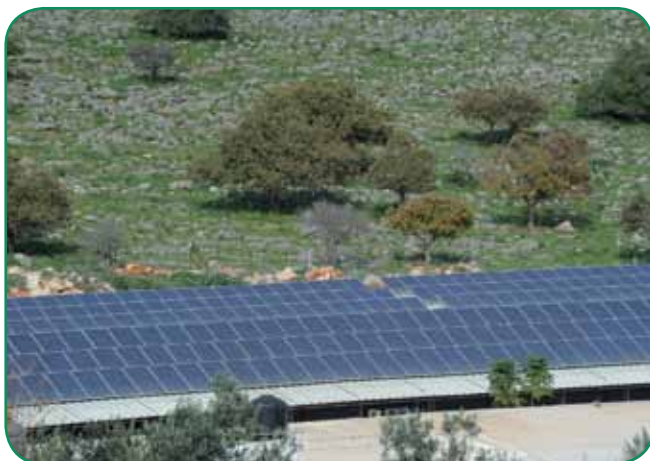
מערכת אנרגיה מתוצרת SunDay בהספק של 100KWP. ממוקמת בכחל, גליל עליון. תפוקה שנתית ל-1 KWP 1810 KWH
